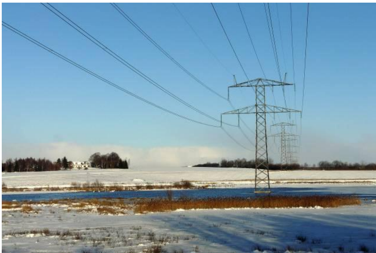
400 kV-ledningen over Årslev Engsø, hvor vi anbefaler en underjordisk linjeføring.
